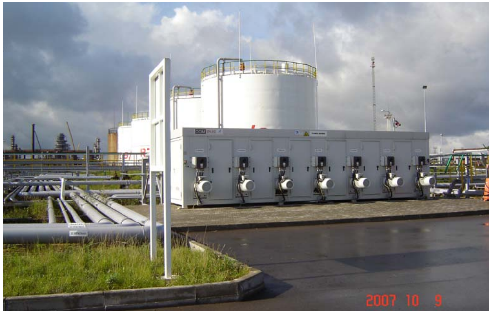
AB Mažeikių nafta produktų atkrovimo į autocisternų estakadą talpyklos ir siurblinė
