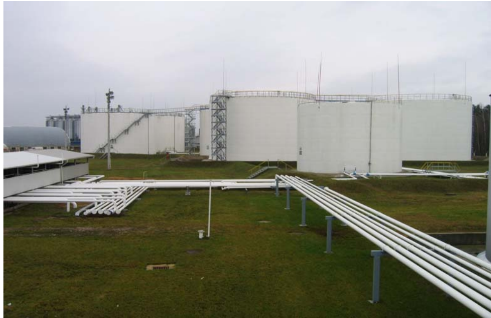
UAB Lukoil Baltija terminalo Kėdainiuose talpyklos ir technologinių vamzdinių linijos
