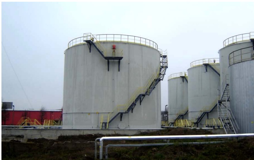
UAB Bendida terminalo talpyklos, nudažytos baltai sidabrine spalva
