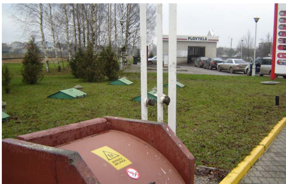
Degalinėje rezervuaro alsuoklio vamzdyje įrengtos garų grąžinimo į cisterną jungtys
