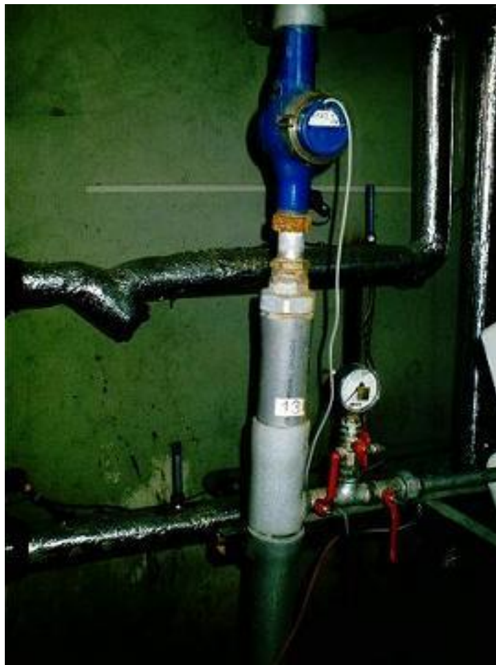
8 paveikslas. Šalto vandens skaitiklis įrengtas šilumos punkte karšto vandens sistemos papildymo šaltu vandeniu linijoje. Skaitiklis rodo name visą karšto vandens suvartojimą ( m^3 ).
